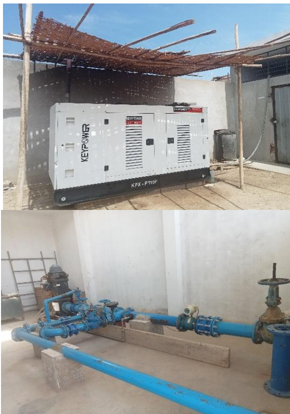
Imagen N° 10: Vista del generador en el pozo N°3
