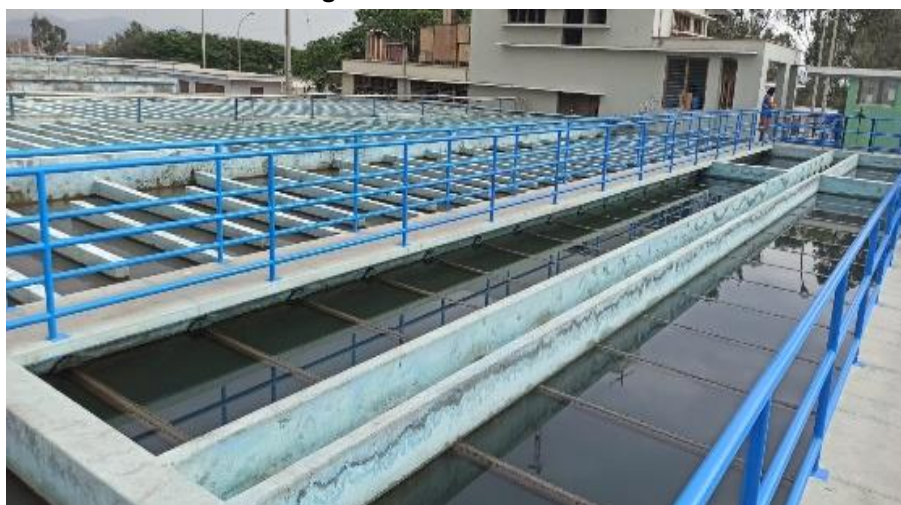
Imagen N° 5: PTAP San Antonio
